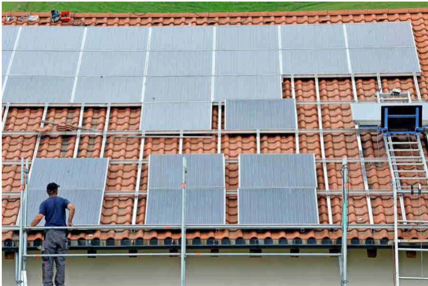
Auch für Neubauten wird eine Solaranlage auf dem Dach in Baden-Württemberg bald zur Pflicht.
